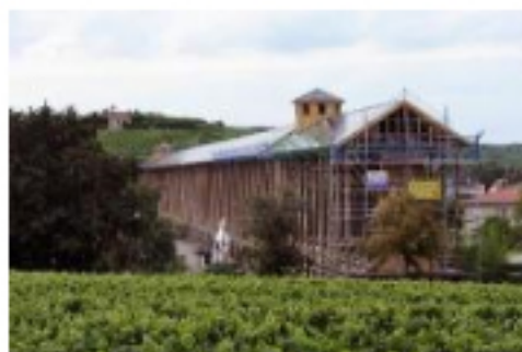
Die fast fertige Saline aus Richtung Süden vor wenigen Wochen. Nun steht die Eröffnung unmittelbar bevor. Archibfoto: Klaus Veins
