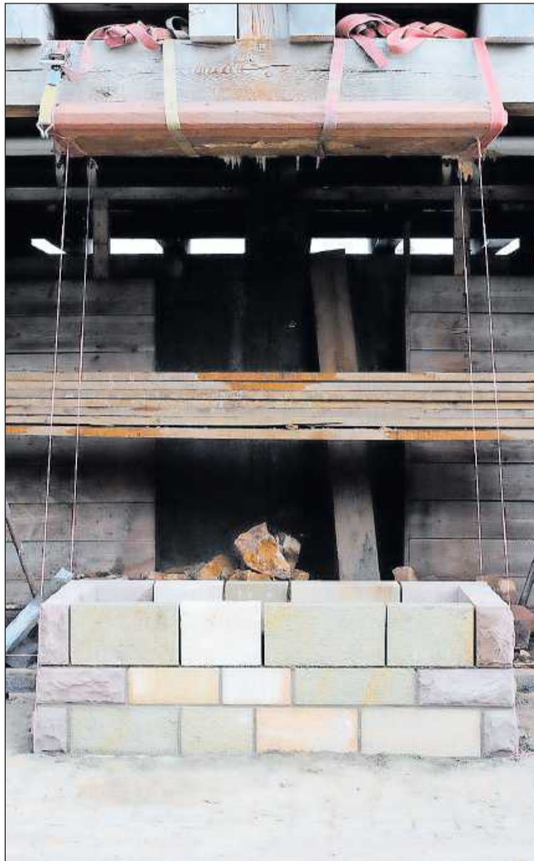
Fehlfarbe: Weil das Rot der äußeren Steine nicht stimmt, musste die Arbeit an einer der Salinensäulen abgebrochen werden. Trotzdem bekommt man einen groben Eindruck, wie sie künftig aussehen sollen.
